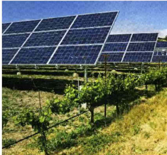
Pannelli solari nei campi
