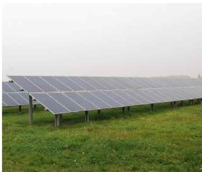
Pannelli fotovoltaici nei campi
